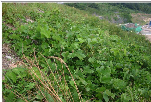
사진 ? 철넝쿨에 의한 녹화부지의 피해
